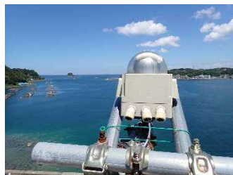
斜張橋のケーブル材監視 （*上向き取付）
