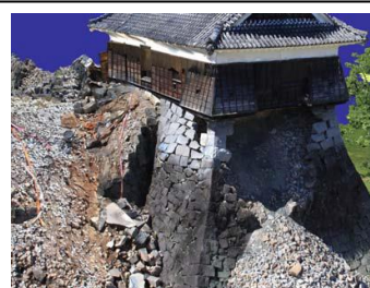
戌亥櫓の石垣崩壊 3D モデル 写真提供:熊本市
