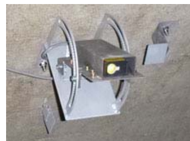
レーザー距離計設置状況 (トンネルの内空変位モニタリング事例)
