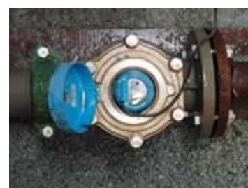
電子式水道メーター (仮設配管)
