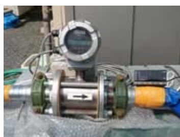
電磁流量計 (仮設配管)
