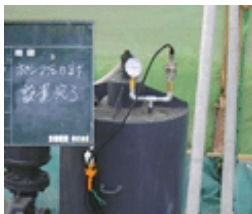
ポンプ圧力 (圧力計)
