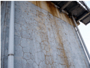
亀甲状のひび割れが生じている鉄道高架橋の橋脚
