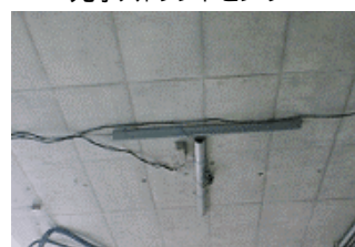
橋梁床版下面での設置状況
