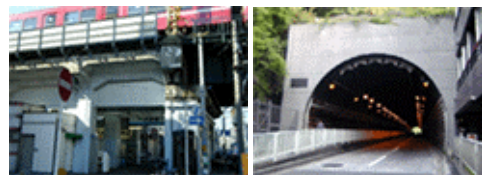
老朽化高架橋橋脚
